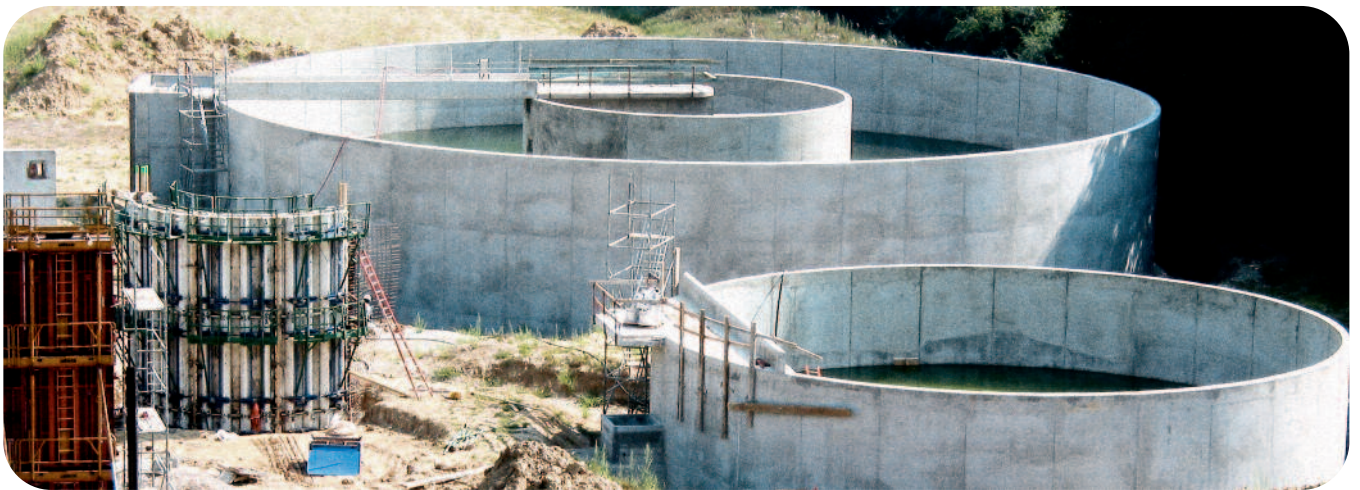
▲ Station d'épuration de Nogent-le-Rotrou
