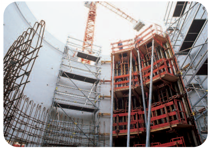
▲ Usine des eaux de Neuilly-sur-Marne
